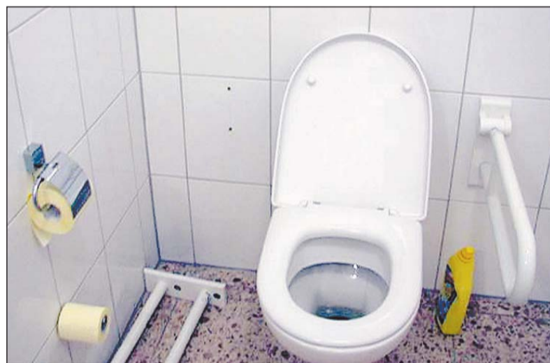
Petra Wolters Lebensgefährte hat nach dem Unfall ein Foto geschossen. Auf dem gefliesten Boden ist der aus der Wand gebrochene Haltegriff zu erkennen, der nur mit dünnen Schrauben befestigt war.
